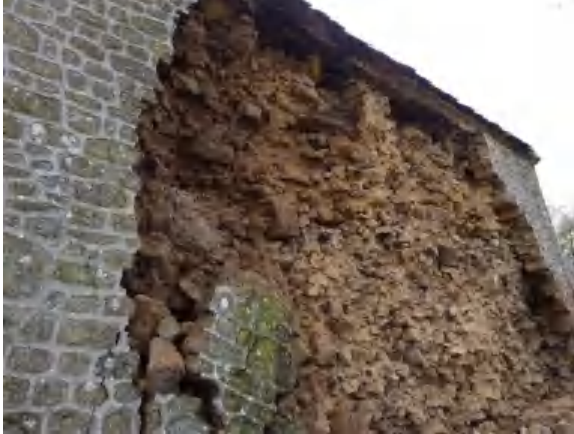
Exemple de flambage, évolutif d'un bouffement de mur
